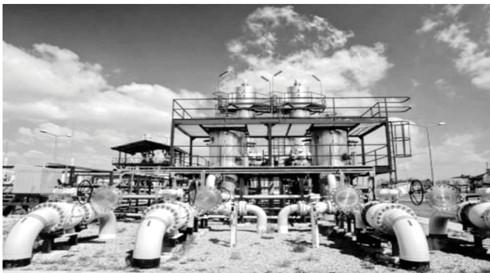
شکل (۱۰) ایستگاه دریافت گاز از لوله اصلی
